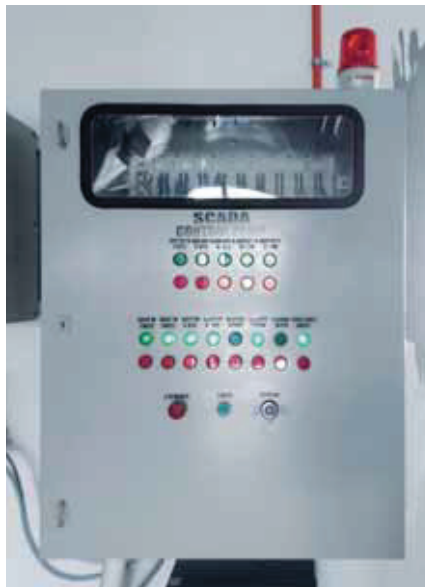
Pannello di controllo del sistema Scada
