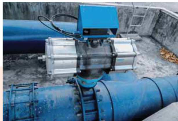
Automazione wireless: una valvola di distribuzione equipaggiata con un attuatore oscillante DAPS 8000 regola la distribuzione dell'acqua alle utenze.
