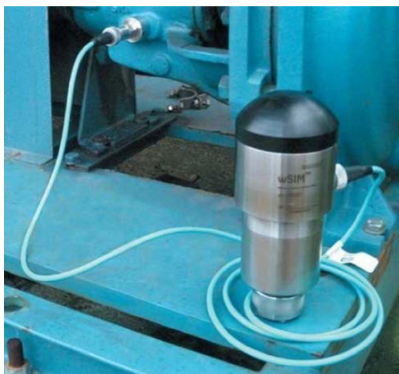
Fig.4 Un nodo sensore wireless alimentato con un generatore a vibrazioni Perpetuum, installato nell'impianto Shell di Nyhamna
