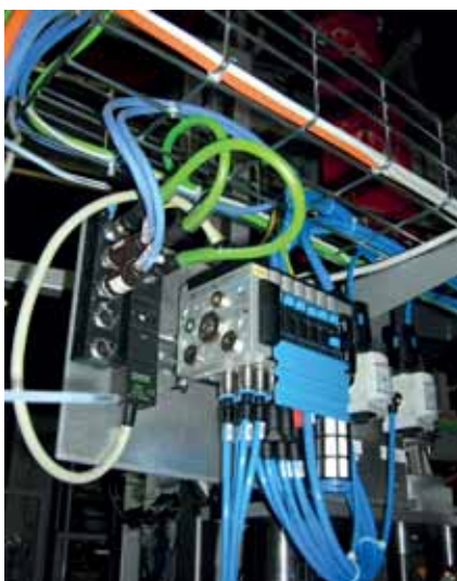
Dettaglio gestione batteria pneumatica di valvole e grandezze analogiche
