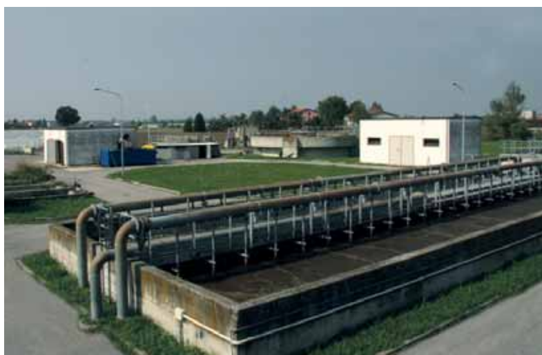
Impianti di depurazione presso Cogozzo di Viadana
