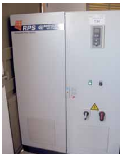
Uno dei 600 inverter prodotti dalla Bonfiglioli per l'impianto di Puertollano.
