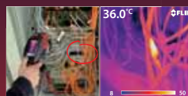
Ispezione di morsetti difettosi.
