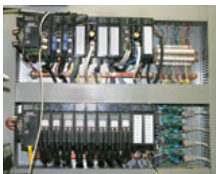
Un PLC Series 90-30 si occupa del controllo della velocità delle eliche sincronizzando le eliche esterne e l'elica interna.
