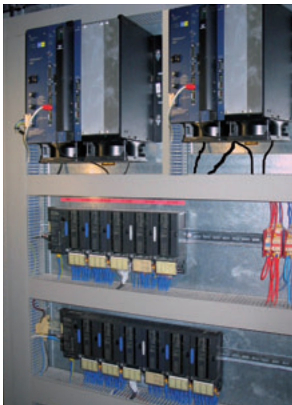
L'impianto di produzione del Mater-BI è regolato da controllori PacSystems Rx7i collegati in ridondanza 'hot back up'
