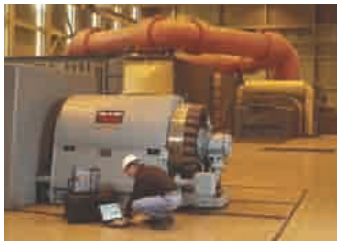
Analisi on line delle vibrazioni su un generatore elettrico con apparecchiatura carrellabile CSI XP32
