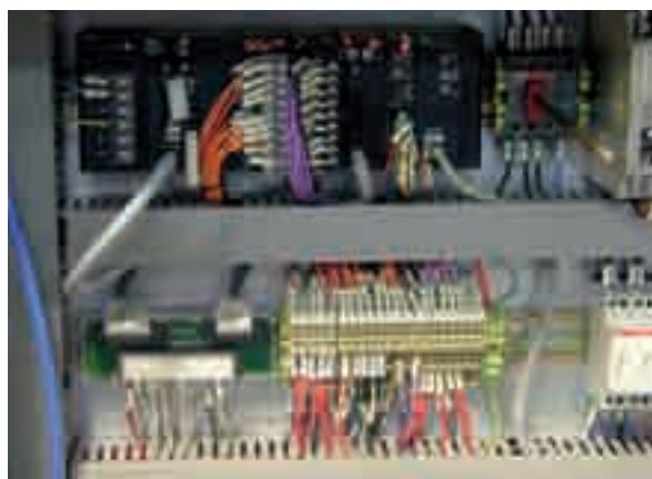
Per le attività di controllo il sistema sfrutta un PLC Omron Serie CJ1 collegato alle varie schede d'ingresso e di uscita remote
