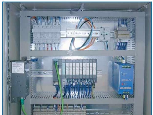
Sulla rete Ethernet sono anche posti un MP370 e tre PC con WinCC per la gestione della supervisione
