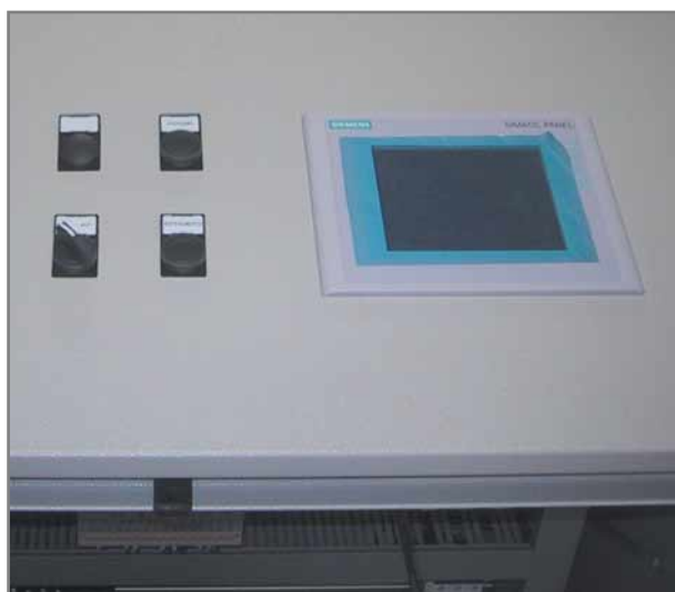
Pulpito dell'operatore con touch-screen Simatic Panel
