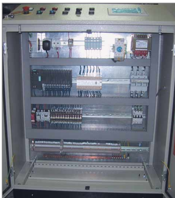
Particolare dell'armadio di controllo dell'impianto
