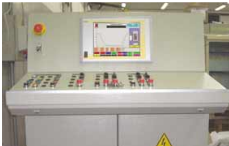
Fig. 8 - Pulpito di comando della linea con Panel PC Siemens IL77
