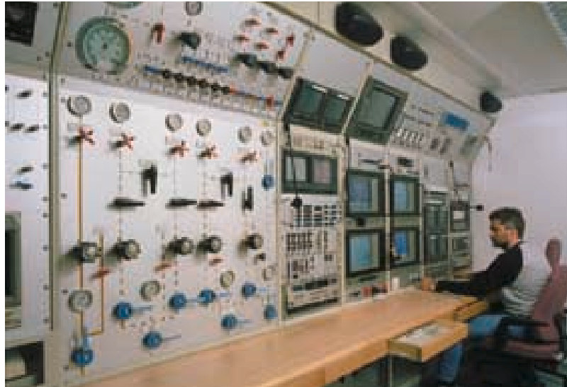
Fig. 9 - L'elaborazione dei dati tecnici è necessaria per mantenere le caratteristiche qualitative del gas, per garantire le condizioni di trasporto e distribuzione, per la manutenzione e il dimensionamento degli impianti (fonte: Sintef)
