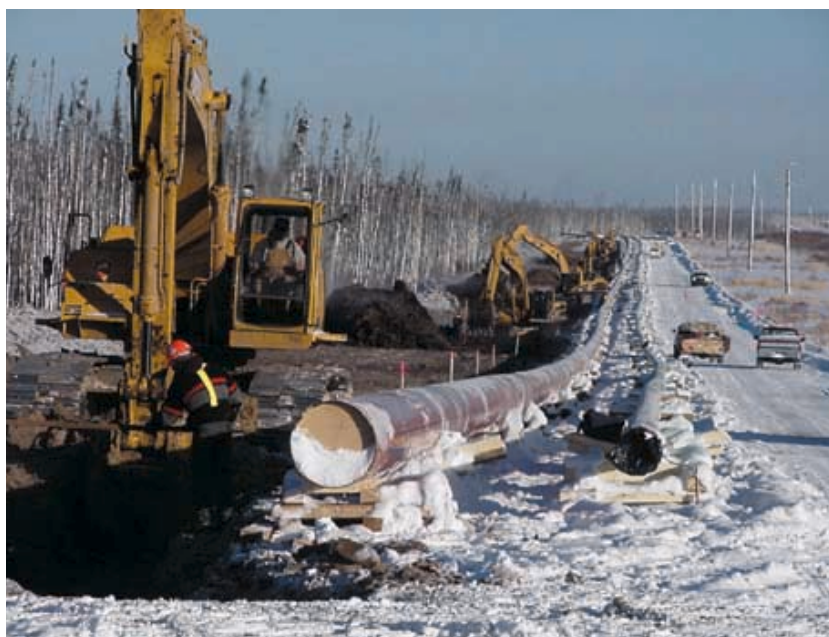
Fig. 5 - Le condotte di distribuzione dei combustibili si estendono per migliaia di chilometri lungo interi continenti; l'automazione del sistema di distribuzione permette il controllo della condotta lungo tutto il percorso (fonte: Midwest)
