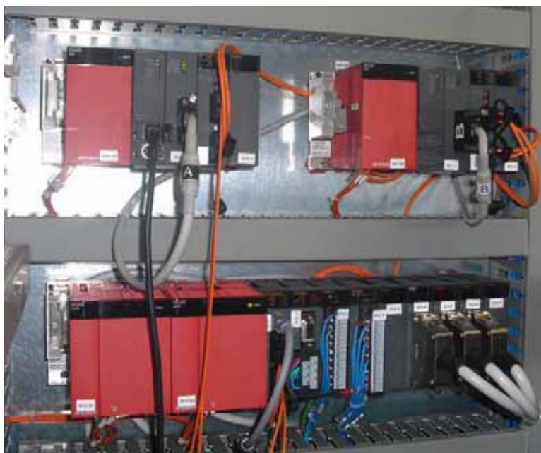
La richiesta di ridondanza nasce dal fatto che l'impianto di raddrizzamento è il cuore dell'impianto industriale
