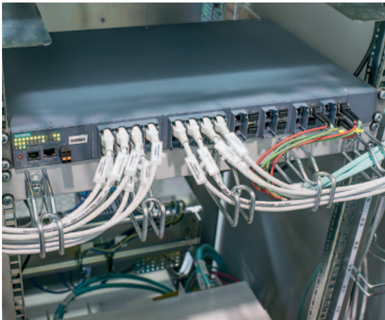
L'applicazione comprende 95 switch Industrial Ethernet della famiglia Scalance X di Siemens con tecnologia FastConnect
