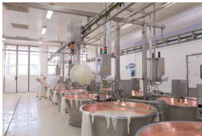
L'automazione del Caseificio viene gestita da 30 PLC Siemens Simatic S7-1215 con Ethernet on board e da altrettanti pannelli operatore
