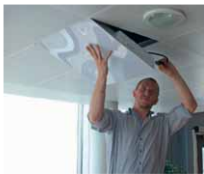
Gli apparecchi di illuminazione DayLight di I-NO sono stati agganciati nel controsoffitto e collegati al sistema Winsta da Wago
