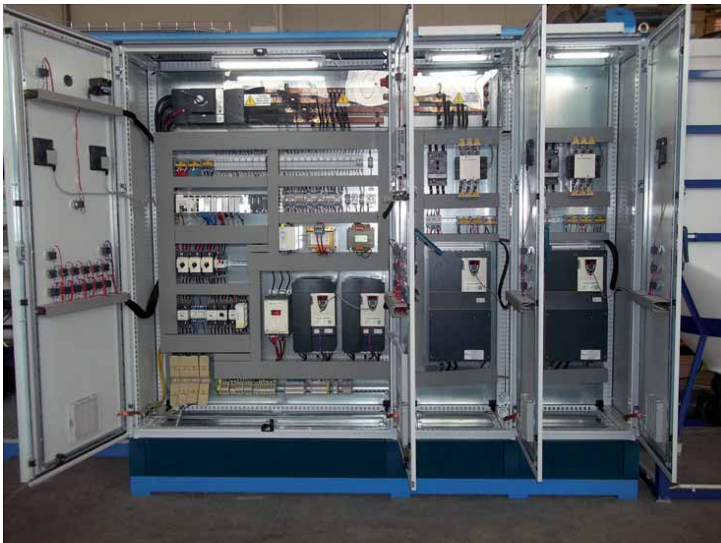
Dettaglio dell'armadio di automazione dell'impianto realizzato da Protecno
