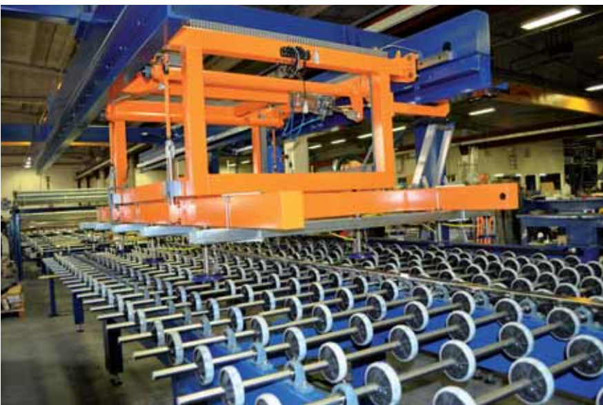
Un particolare dell'impianto
