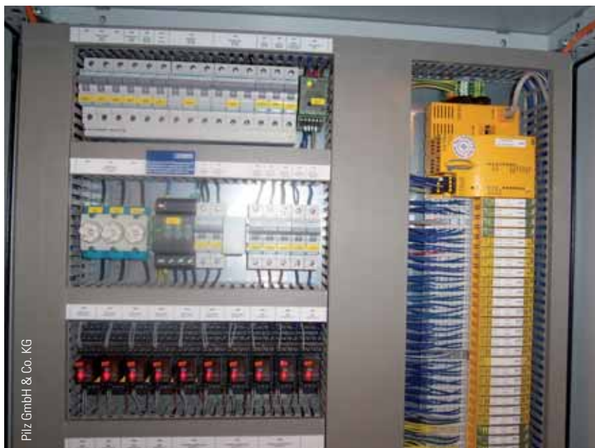
20 controllori PSSuniversal PLC, installati in diversi punti dell'edificio e collegati tramite switch PSSnet, garantiscono il controllo e il comando dell'impianto antincendio
