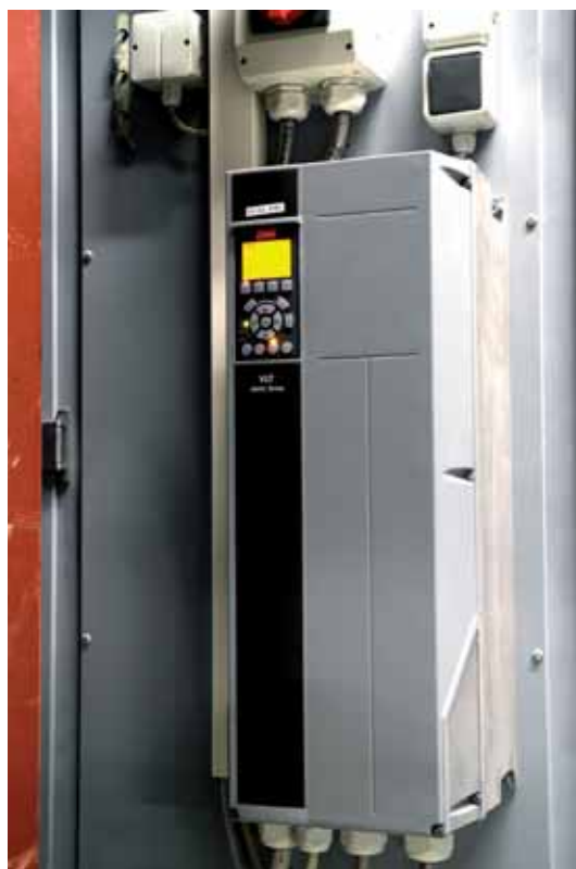
Il sistema di ventilazione utilizzato impiega i convertitori Danfoss VLT con interfaccia Bacnet
