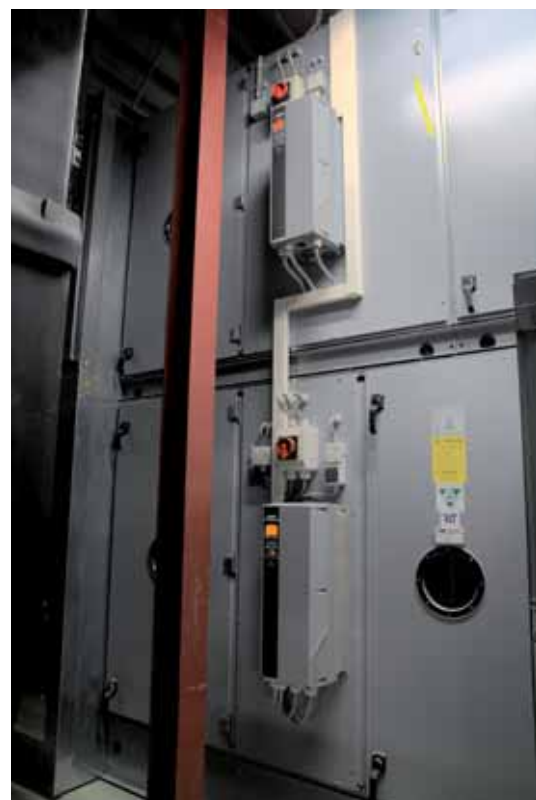
L'impiego di un convertitore permette di ottenere significativi risparmi energetici
