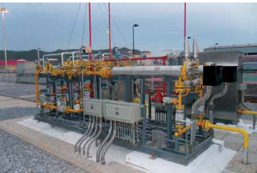
Particolare della stazione di controllo del gasdotto
