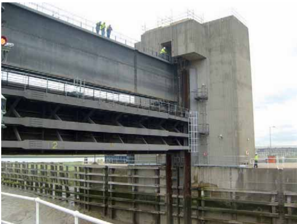
Le paratie sono sollevate e abbassate tramite motori oleoidraulici ad azionamento diretto
