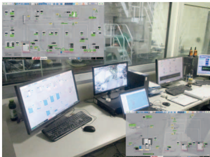
La supervisione dell'impianto utilizza dei PC e copre l'intero ciclo produttivo della cartiera, dal trattamento della cellulosa alla produzione della bobina
