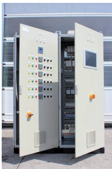
Uno dei quadri di controllo e di potenza con tecnologia ABB
