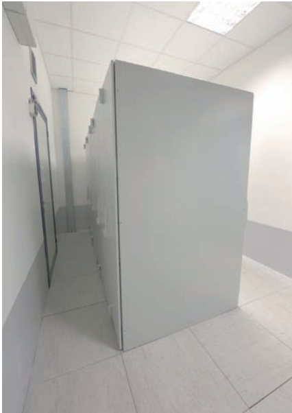
Vista posteriore del data center: una soluzione basata su armadi chiusi
