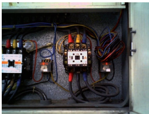
Figura 2 - Punti caldi nel cablaggio di una connessione elettrica
