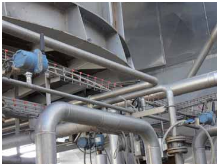
Un'installazione wireless di Emerson
