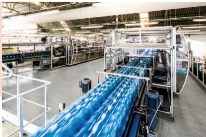
Una linea automatica di confezionamento realizzata da Acmi, che utilizza armadi, sistemi di raffreddamento e di distribuzione di corrente prodotti da Rittal
