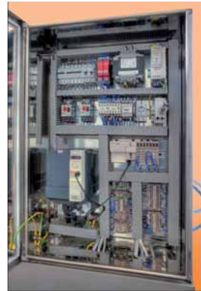
Il quadro elettrico di una macchina Mixtral
