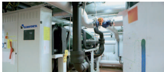
^ In questo progetto le pompe di calore Climaveneta raffreddano l'acqua del data center da 15 °C fino a 10 °C
