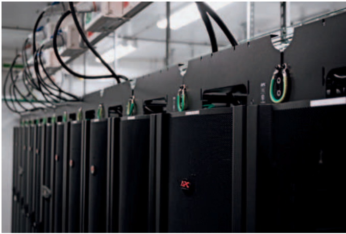
^ L'acquisizione da parte di Schneider Electric di AST Modular, fornitore di data center modulari sicuri ed efficienti, ha dato al progetto una marcia in più
