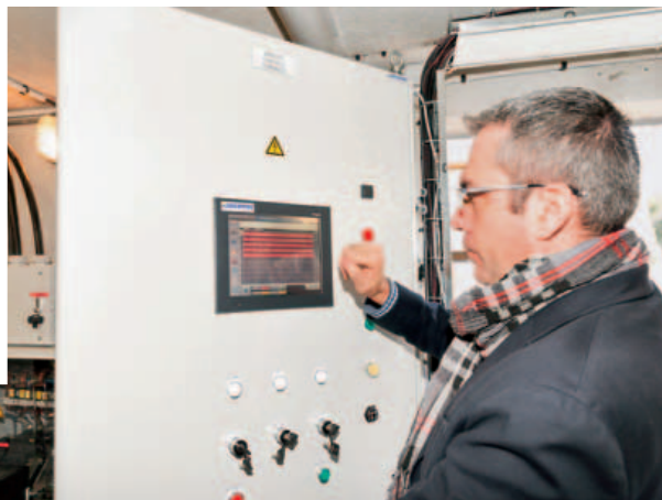
< Messa in servizio di 4 convertitori Sunsys PCS 2 installati nella cabina di trasformazione del quartiere (Foto di Albane Noor)
