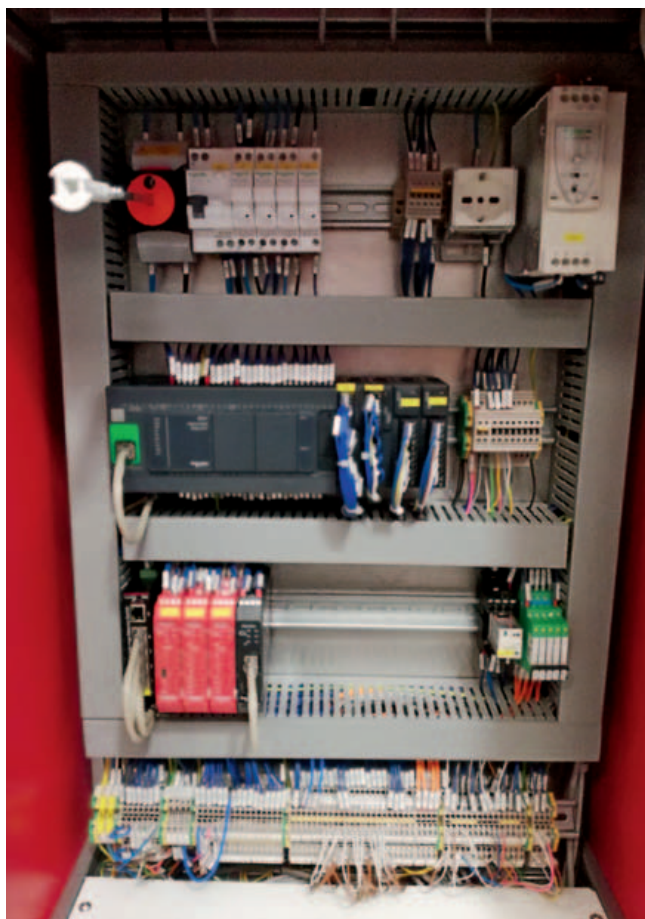
Interno dell'armadio dove risiede l'automazione di macchina
