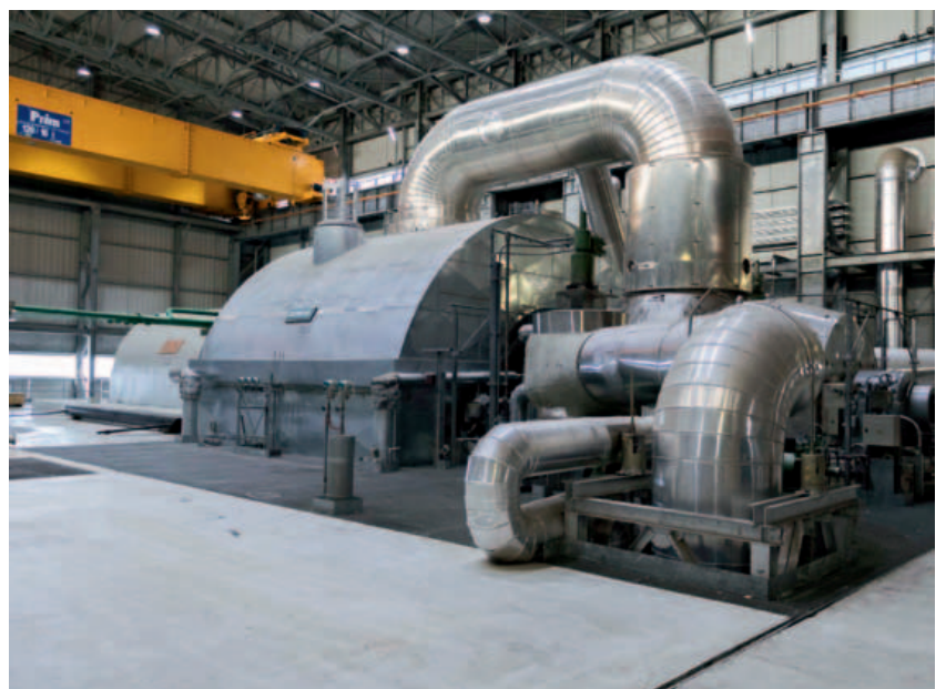
L'impianto di Termoli compone insieme alle altre centrali a ciclo combinato di Modugno, Bertinico - Turano Lodigiano e Aprilia il parco termoelettrico dell'azienda per una potenza installata di 3.175 MW
