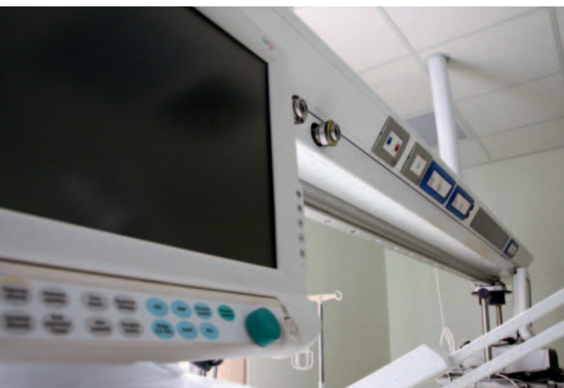
Nei locali a uso medico gli impianti elettrici devono soddisfare la Sezione 710 della norma CEI 64-8
