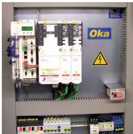
Vista attraverso la porta di vetro dell'armadio di controllo: la soluzione di automazione PacDrive 3 con il controller LMC400C e la soluzione servo Lexium 62, con alimentazione elettrica condivisa e due drive doppi. In basso, il contatore delle ore di operatività e alcuni dei componenti elettrici e meccanici provenienti da varie linee di prodotto di Schneider Electric
