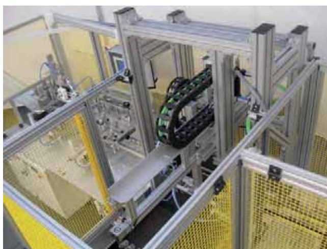
La gestione della movimentazione è realizzata con la soluzione PacDrive3
