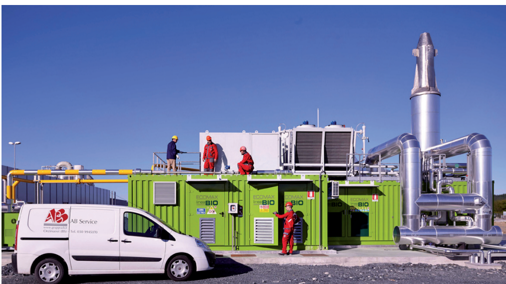
L'impianto di biogas realizzato e installato da AB presso lo stabilimento di Amadori a San Vittore di Cesena
