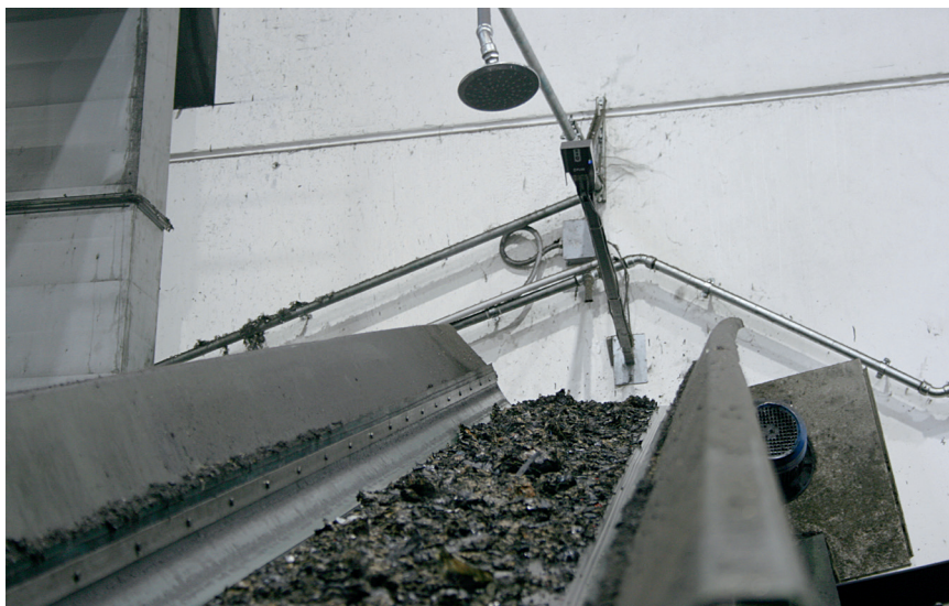
Flir AX8 dedicata al controllo materiale su nastro trasportatore
