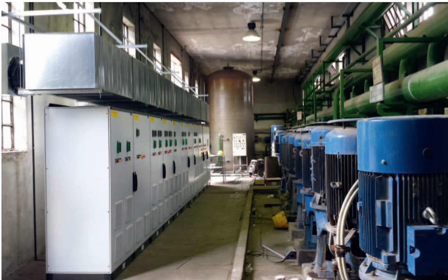
Il quadro di controllo per le pompe di raffreddamento del forno e della colata realizzato da Schneider Electric per Leali Steel
