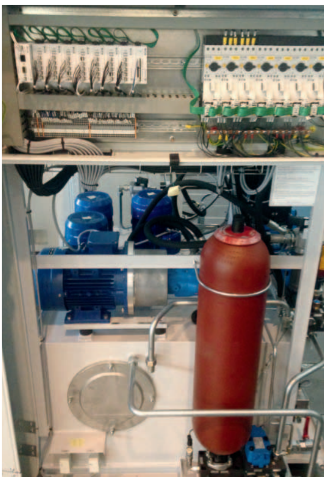
Eaton ha proposto la fornitura dei componenti idraulici ed elettrici insieme alla propria tecnologia di cablaggio intelligente SmartWire-DT
