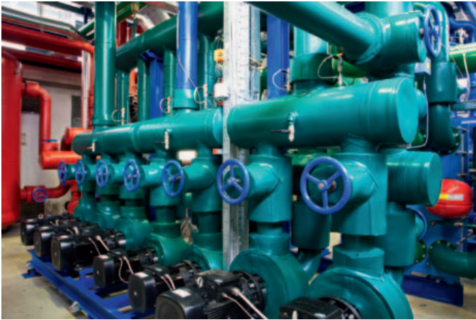
Nell'impianto di trigenerazione, diversi sensori di processo controllano le temperature, le pressioni o i flussi
