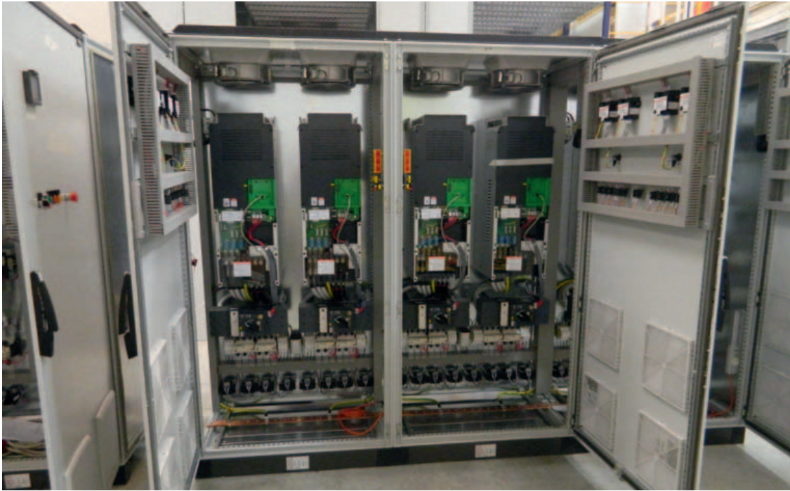
Particolare interno del quadro di controllo
