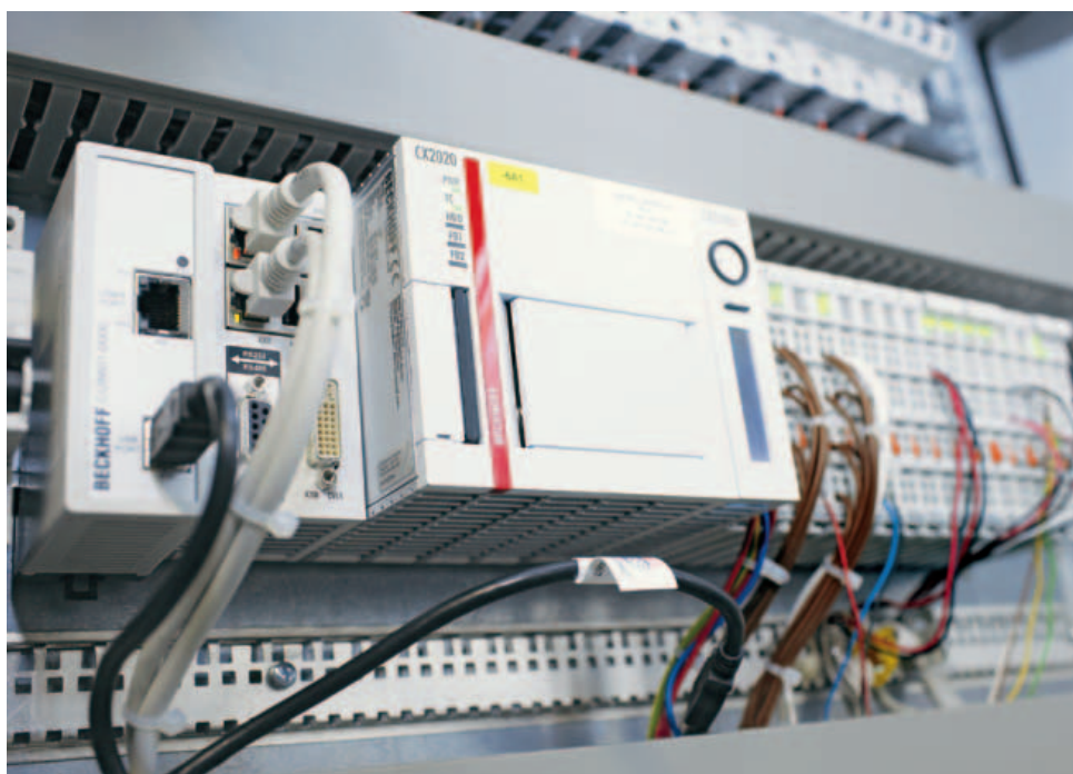
Il PLC CX2020 nel quadro di comando
