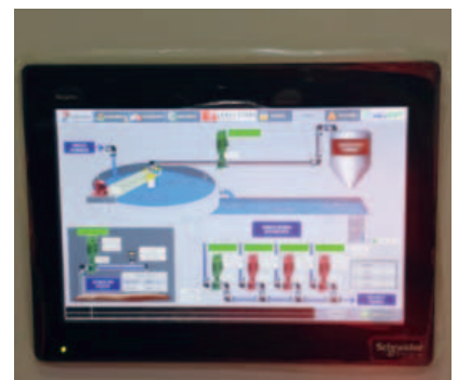
Per l'interfaccia HMI del quadro di controllo è stato adottato un prodotto della gamma Magelis GTU di Schneider Electric
