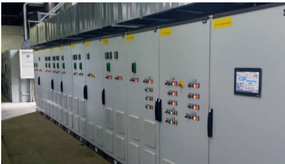
Il quadro di controllo per le pompe di raffreddamento del forno e della colata realizzato da Schneider Electric per Leali Steel
