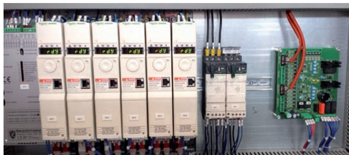
Dettaglio del quadro di automazione, in evidenza gli inverter Altivar di Schneider Electric
