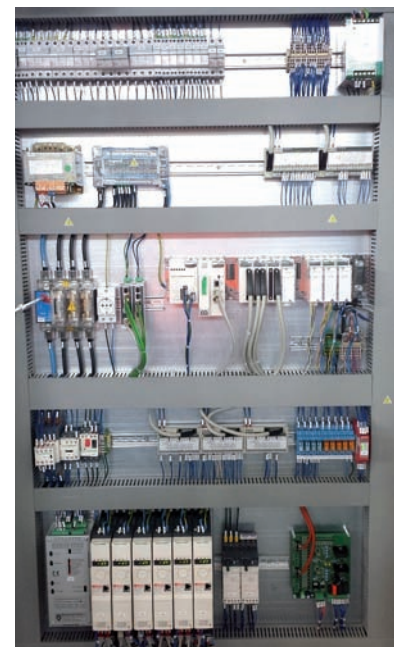
Vista d'insieme del nuovo quadro realizzato con le soluzioni di Schneider Electric
