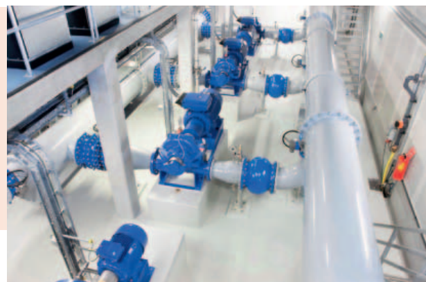
Figura 1 - La stazione di Nieuwdorp ha una struttura 'a due vie' che assicura la piena disponibilità di almeno un gruppo pompe per garantire l'approvvigionamento continuo di acqua
