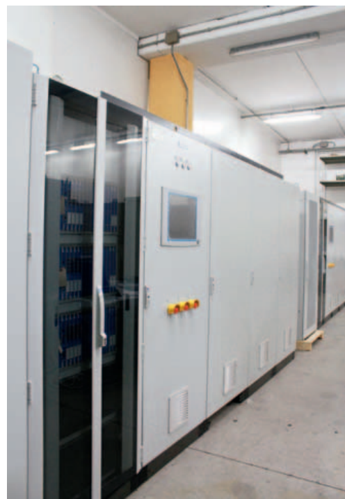
Il sistema centrale di controllo, per una centrale elettrica a turbogas in Russia, è stato racchiuso in diversi gruppi composti da armadi Rittal
