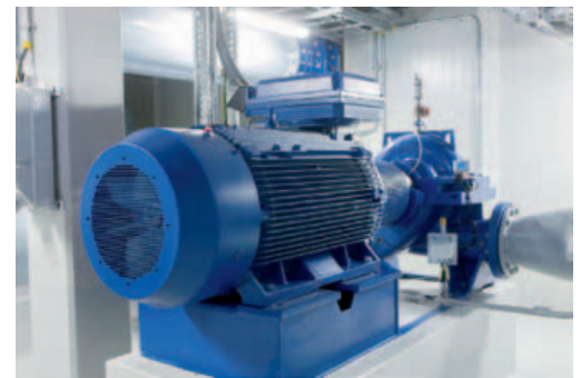
Figura 2 - Affidabilità ed efficienza energetica sono i criteri chiave adottati da Evides per la scelta di apparecchiature che devono durare 20-30 anni
