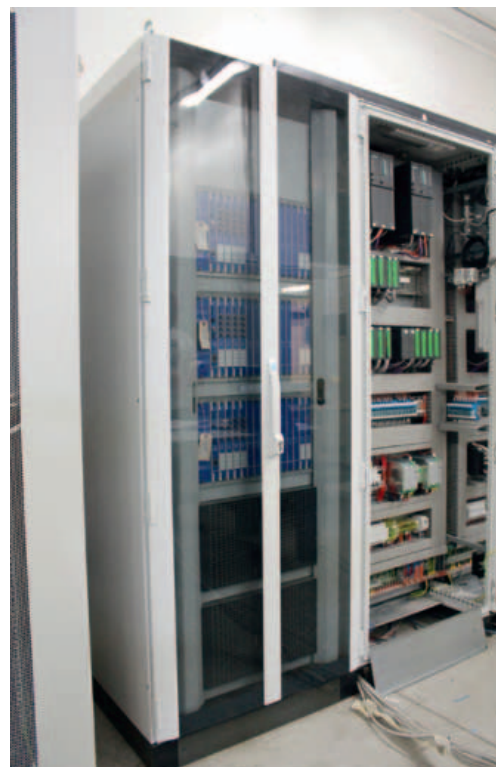
Una vista degli armadi standard prodotti da Rittal e utilizzati da Seid
