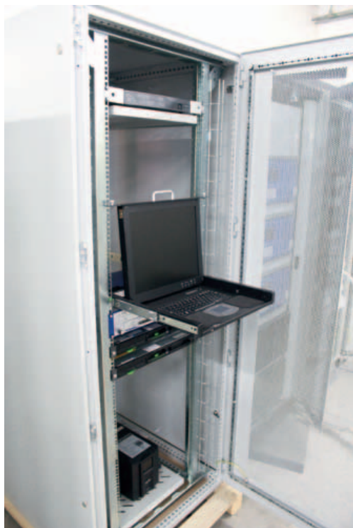
Per ottimizzare l'efficienza del raffreddamento, un armadio può essere dotato di porta frontale perforata che, con un'estesa superficie di ventilazione, consente il raffreddamento passivo
