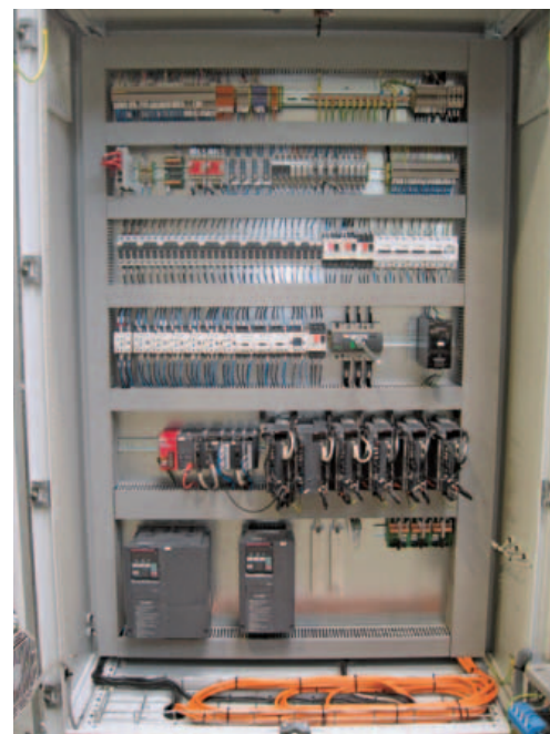
L'armadio elettrico della macchina per la stampa del sapone solido comprende PLC, schede di controllo e servosistemi di Mitsubishi Electric
