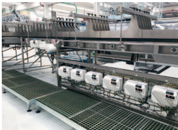
La linea di imbottigliamento con gli azionamenti Danfoss Drives
