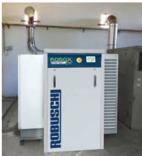
^ La flessibilità e versatilità del nuovo Robox energy è stata dimostrata anche nei confronti del PLC di Iren installato nell'impianto
