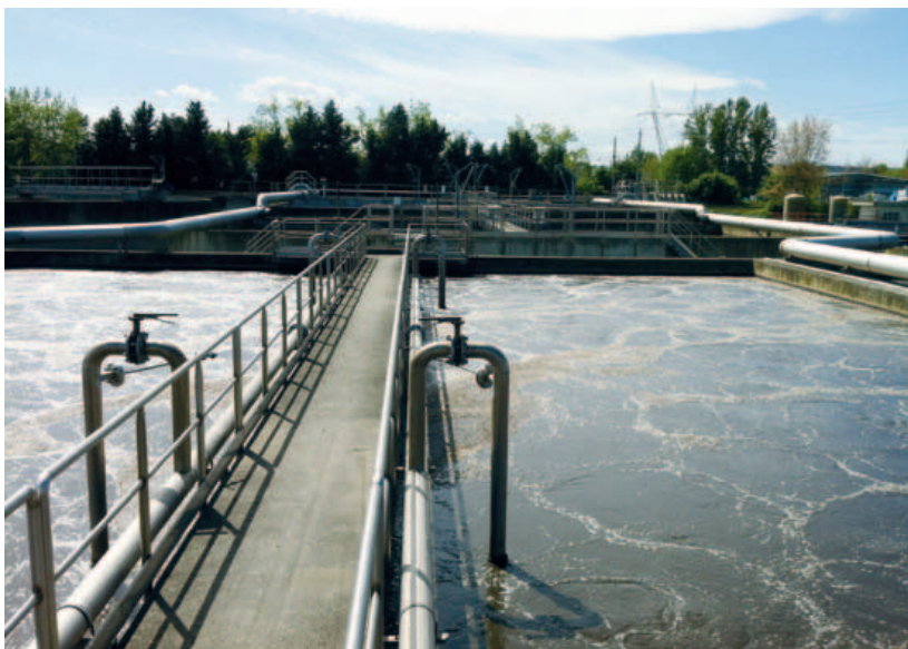
^ Il progetto di ammodernamento dell'impianto di depurazione emiliano ha visto lavorare fianco a fianco i tecnici di Iren e di Robuschi
