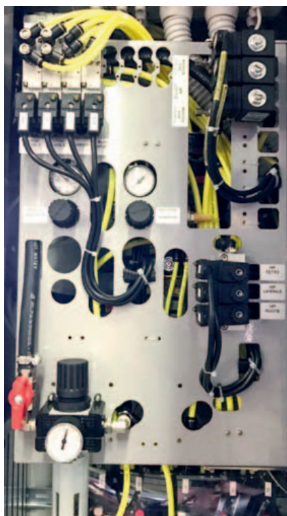
^ Le elettrovalvole e gli FRL Aignep provvedono all'apertura e alla chiusura dei circuiti nella gestione dell'acqua dell'impianto
