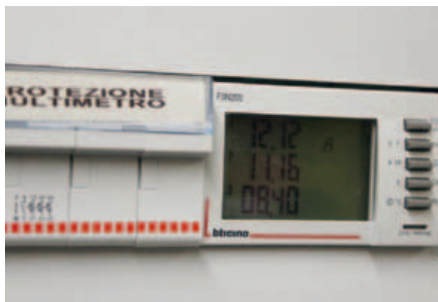
^ In caso di necessità, è possibile assumere il controllo anche da locale. Ma l'azione viene immediatamente segnalata al software di supervisione
