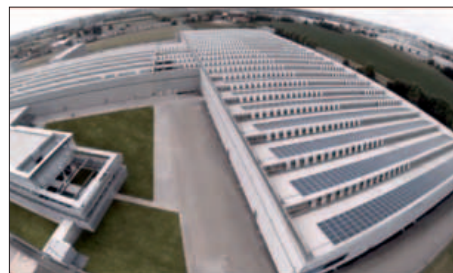
L'impianto fotovoltaico da 1 MW di Rubinetterie Bresciane
