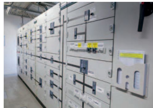
Il quadro di distribuzione primaria di bassa tensione
