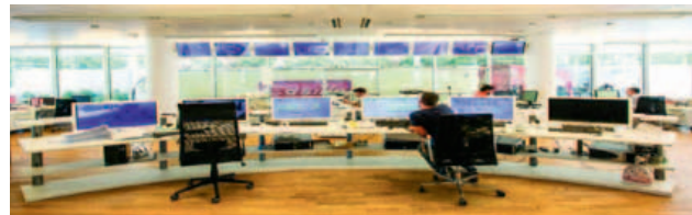
Il progetto innovativo legato a Industria 4.0 permette oggi al Gruppo di gestire molte attività da un'unica sala di controllo
