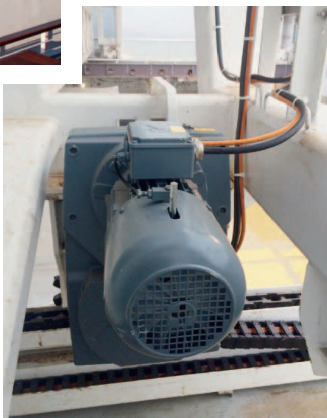
La copertura Skydome è azionata mediante motoriduttori Nord
