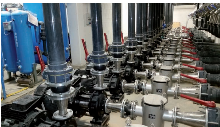
Le 21 pompe ad alta efficienza Grundfos dotate di inverter
