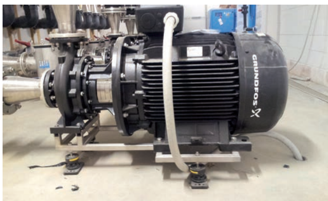
La pompa centrifuga Grundfos NB 80-250/257 che ha alimentato l'ugello water screen della Lake Arena
