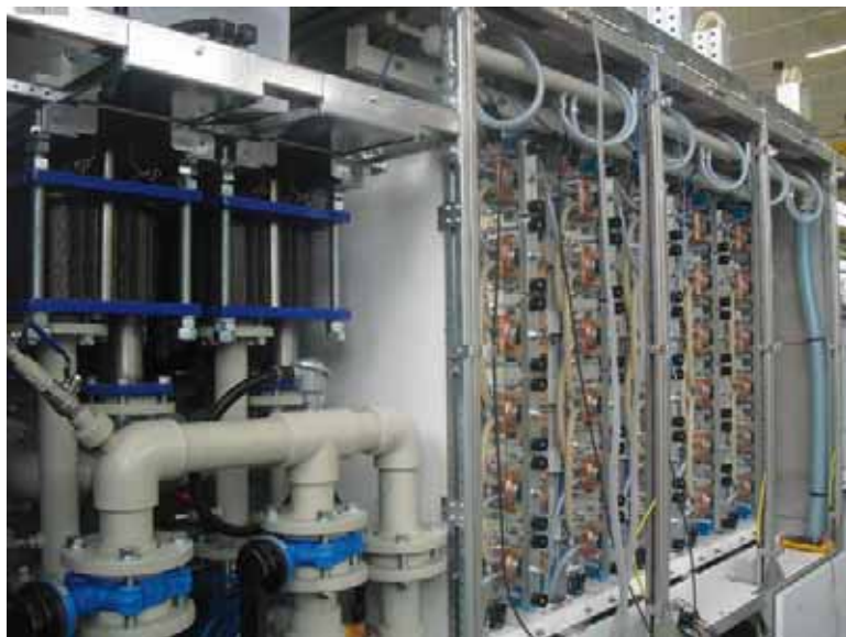
Le macchine di Friem sono raffreddate da acqua deionizzata e acqua industriale che circolano all'interno di uno scambiatore industriale di calore
