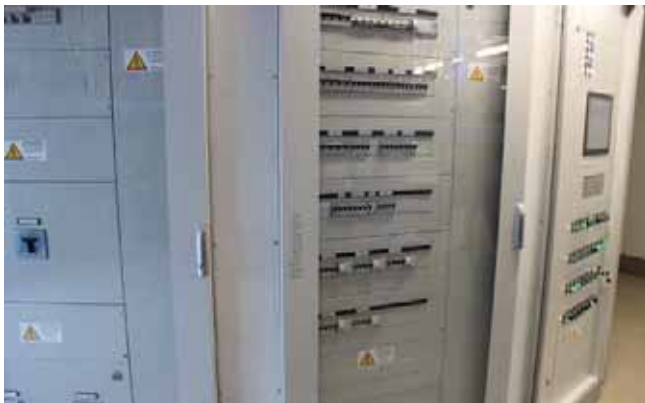
Un particolare del power center, sulla sinistra si intravedono gli interruttori scatolati Megatiker
