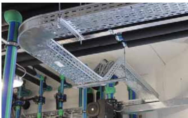
Le passerelle metalliche forate GammaP P31, sostengono e proteggono i 24 km di cavi dell'impianto
