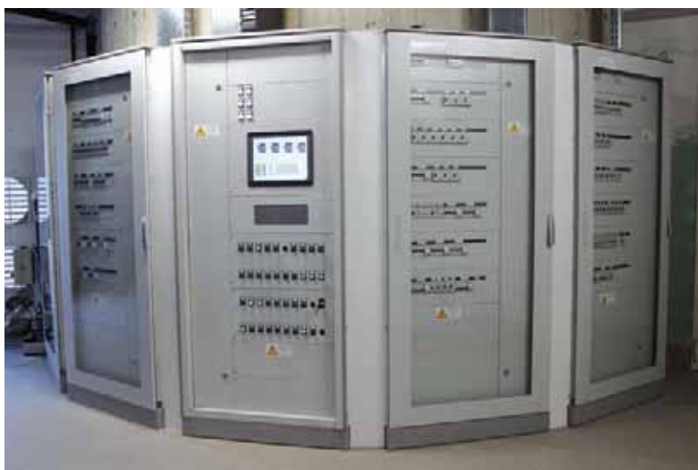
Nel Power Center di Y-40 anche gli armadi sono disposti circolarmente attorno alla scala
