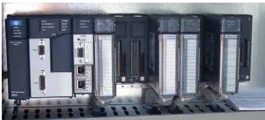
La scelta di potenziare la capacità produttiva dello stabilimento ACS Dobfar di Tribiano ha portato ad avvalersi di PLC GE Intelligent Platforms RX3i e Proficy HMI/Scada iFix 5.1
