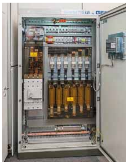
Il quadro elettrico dell'estrusore ES135C include interruttori per protezione motore PKZ0 collegati al PC industriale XP700 tramite il cavo SmartWire-DT
