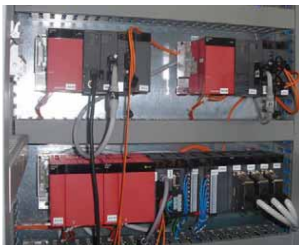
Il PLC, i regolatori digitali e l'analizzatore di rete corrono su protocollo Modbus e si interfacciano con un pannello operatore GT16 della serie GOT1000, dove tutte le informazioni del sistema vengono acquisite e visualizzate
